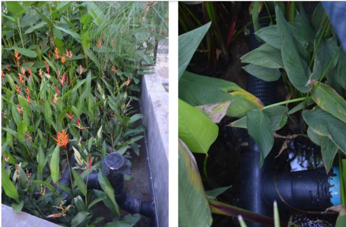
ภาพ 10 ท่อน้ำเสียระบบ (VF)
