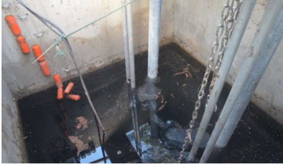
ภาพ 6 ภายในบ่อพักน้ำเสียมีเครื่องสูบน้ำเสีย 2 เครื่อง
