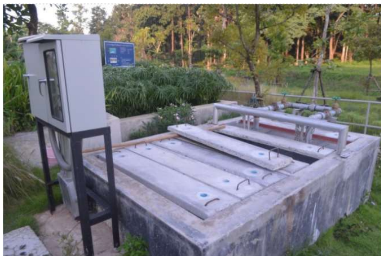
ภาพ 5 บ่อบำบัดน้ำเสีย
