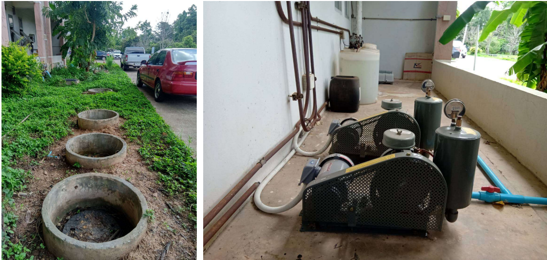
ภาพ 4 บ่อบำบัดน้ำเสียแบบเติมอากาศ
